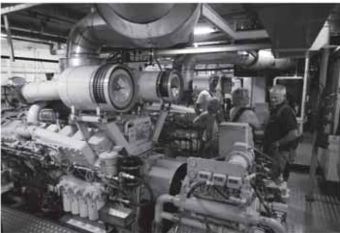
L'impressionnante salle des machines de l'Insula Oya 2
