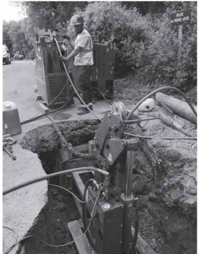
Un système hydraulique permet de tirer le tuyau en PEHD renforcé qui va servir de canalisation
